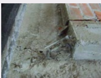
Fig.12. M4-Fase 2. Grieta en la base.
