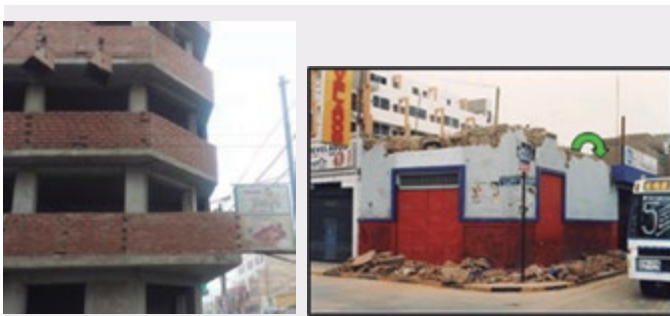
Fig. 1. Parapeto de albañilería sin arriostrar y volcamiento.
