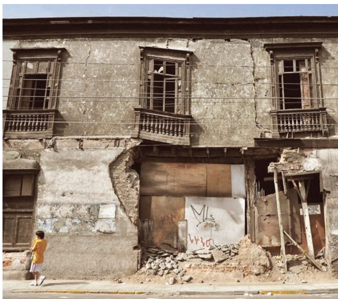
Figura 1. Muchas de las viviendas de adobe en el centro de Lima no han sido refaccionadas, estas son altamente vulnerables.
