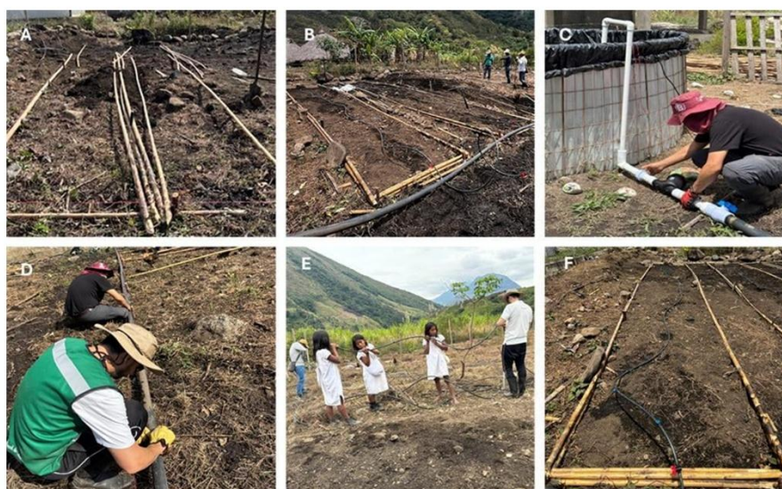
Figura 6. Instalación de camas de cultivo y sistema de riego
