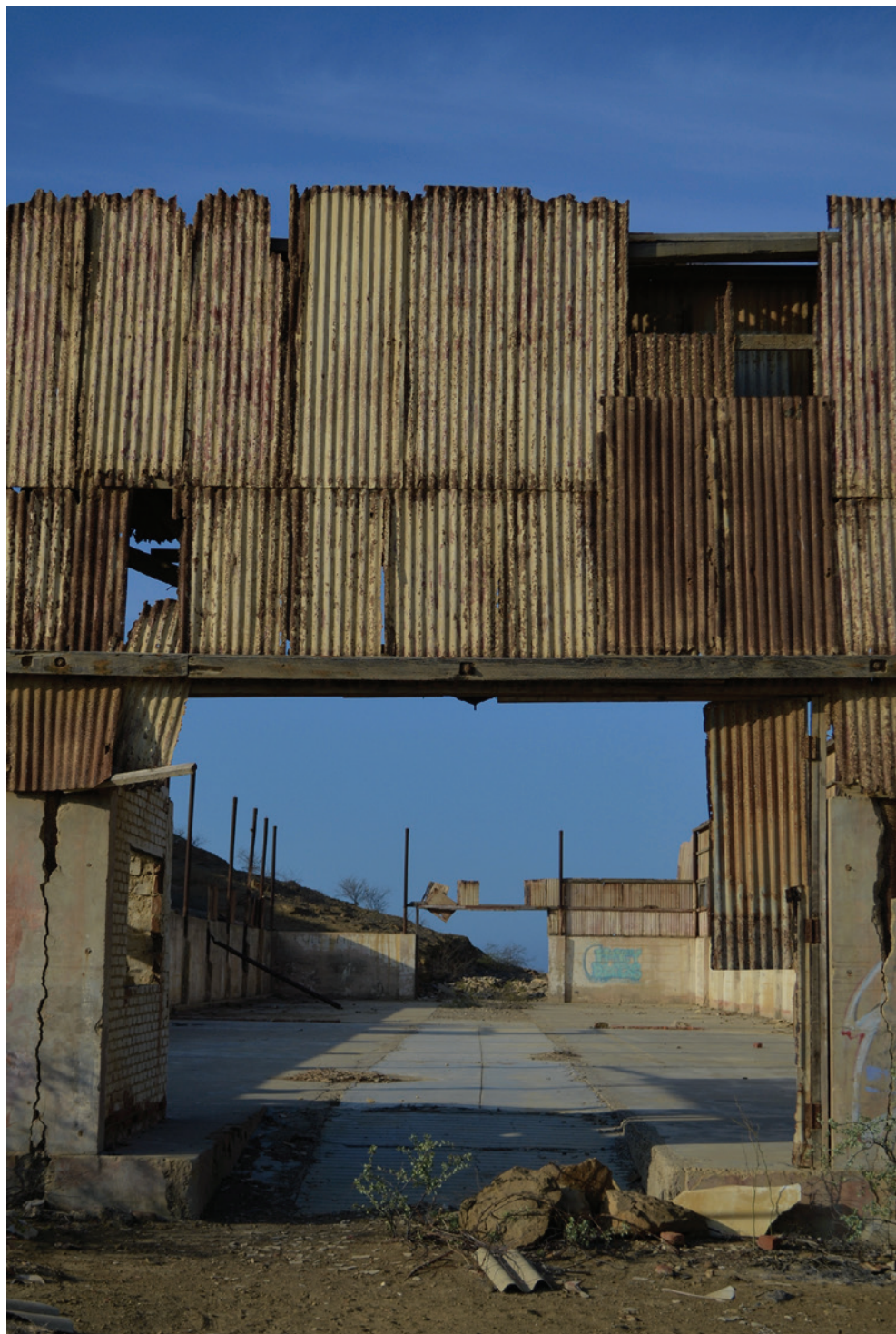
Vista interior del antiguo casino de Lobitos. Actualmente está abandonado, a excepción de un cuarto que fue invadido y remodelado por un poblador para aperturar un restobar.
