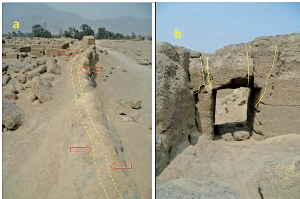
Figura 8. a) Ondulaciones de las paredes en el Sector Oeste del Conjunto Villar-Córdova (Cajamarquilla). b) Deformación de la parte superior del pórtico en el sector Villar Córdova (Cajamarquilla).
