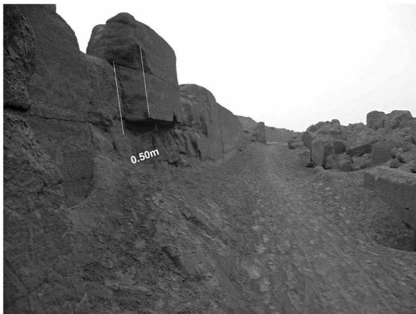
Figura 3. Desplazamiento de bloques de tapiales que afectan a las paredes del sector meridional del Conjunto Tello (Cajamarquilla), aquí se puede observar que el desplazamiento en algunos lugares llega hasta el medio metro.
