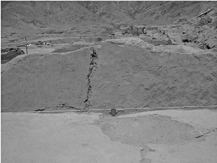
Figura 5. Hundimiento parcial del piso, en el que se puede observar el desacoplamiento parcial en el contacto de la pared con el piso, sitio arqueológico Catalina Huanca.
