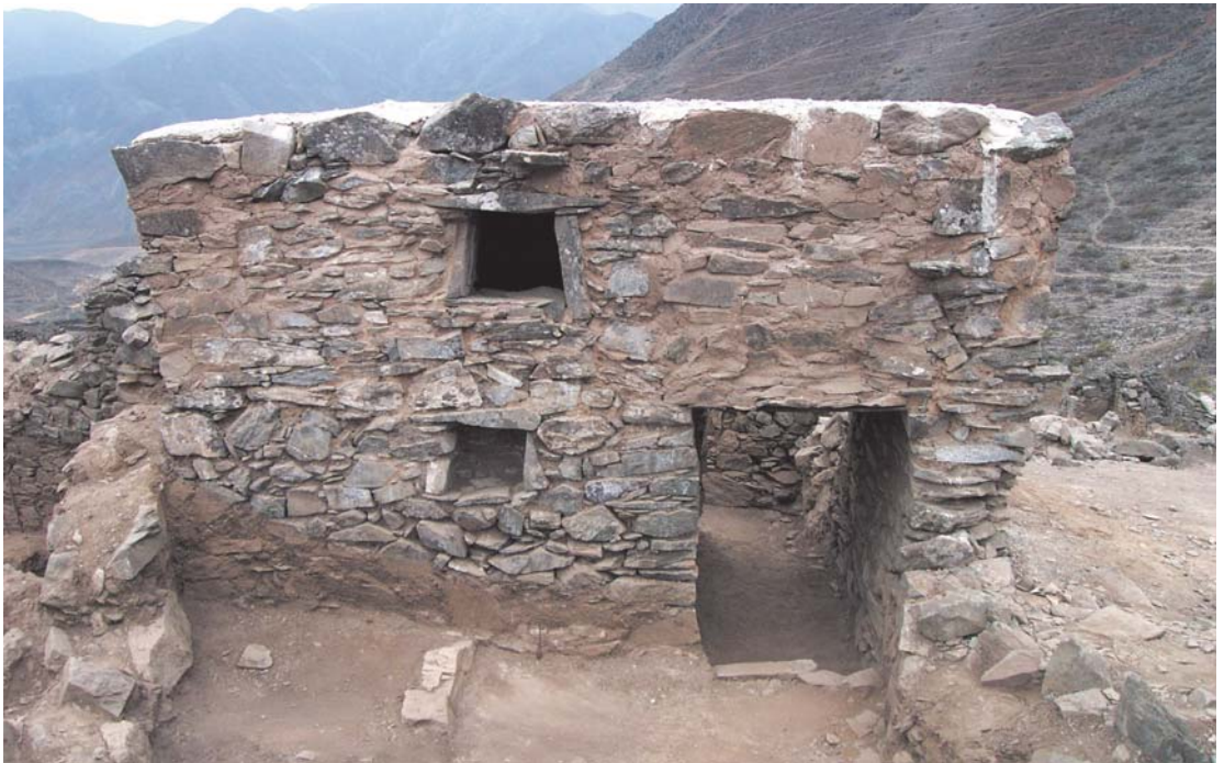
Fig. 7B. Ejemplo de mampostería (Sector III, UE 1, estructura ET 29). Estado después de los trabajos de consolidación (Foto: K. Makowski).
