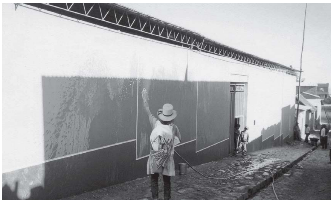
Fig. 6. Fachada de la collca moderna de Tupicocha, después del techado de 1998 (Foto: F. Salomon).
