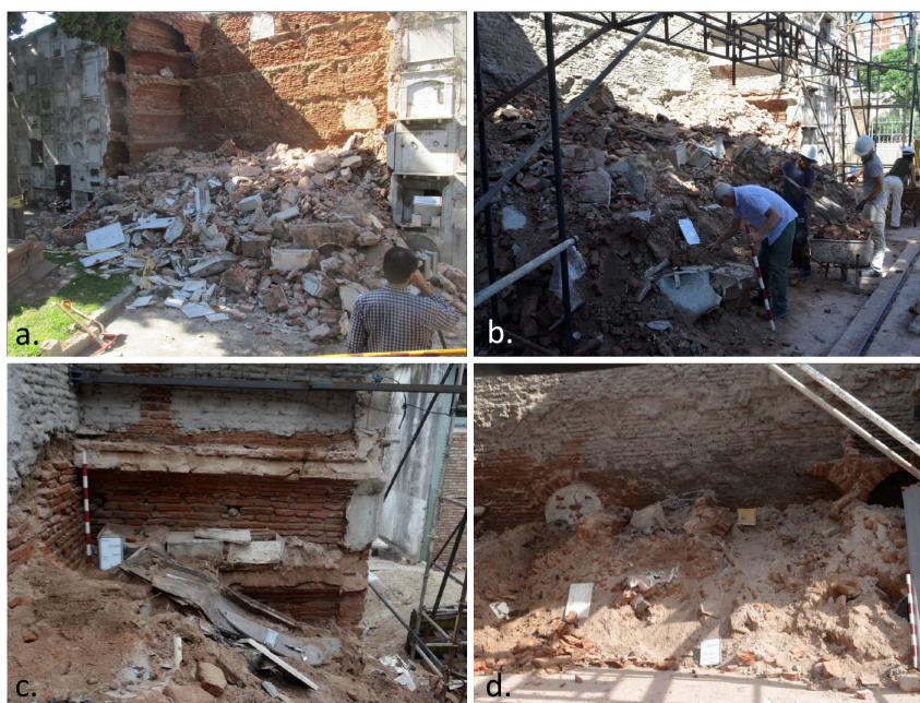
Figura 1. Derrumbe del ala E del primer cuerpo de nichos y trabajo de rescate. a. Vista general del derrumbe; b. Excavación controlada y registro de hallazgos; c. Afección de las estructuras funerarias ocasionada por el derrumbe de los nichos; d. Vista del sector central durante el avance de la remoción de escombros (fotografías reproducidas con permiso de J. M. López Mazz).
