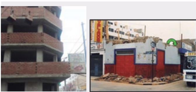
Fig. 1. Parapeto de albañilería sin arriostrar y volcamiento.
