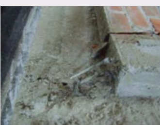
Fig.12. M4-Fase 2. Grieta en la base.
