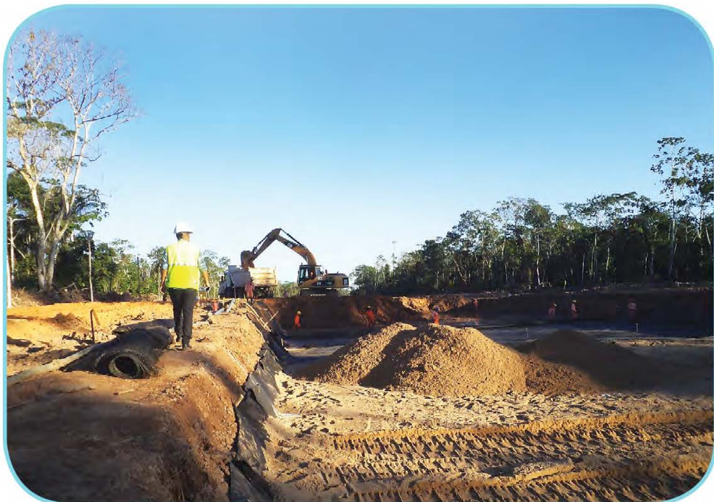
Fig. 1: Trabajos en Sub Tramo III del Acceso al Nuevo Puerto de Yurimaguas (Zona Inundable).
