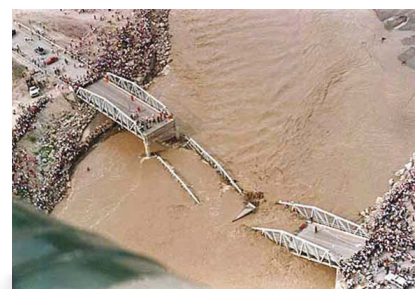
Figura 3/ El colapso de puentes limitó las actividades de ayuda a sectores vulnerables. Fuente revista Caretas
