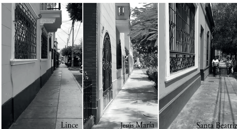
Figura 3. Fachadas categorizadas como Tipo B en Lince, Jesús María y Santa Beatriz.
