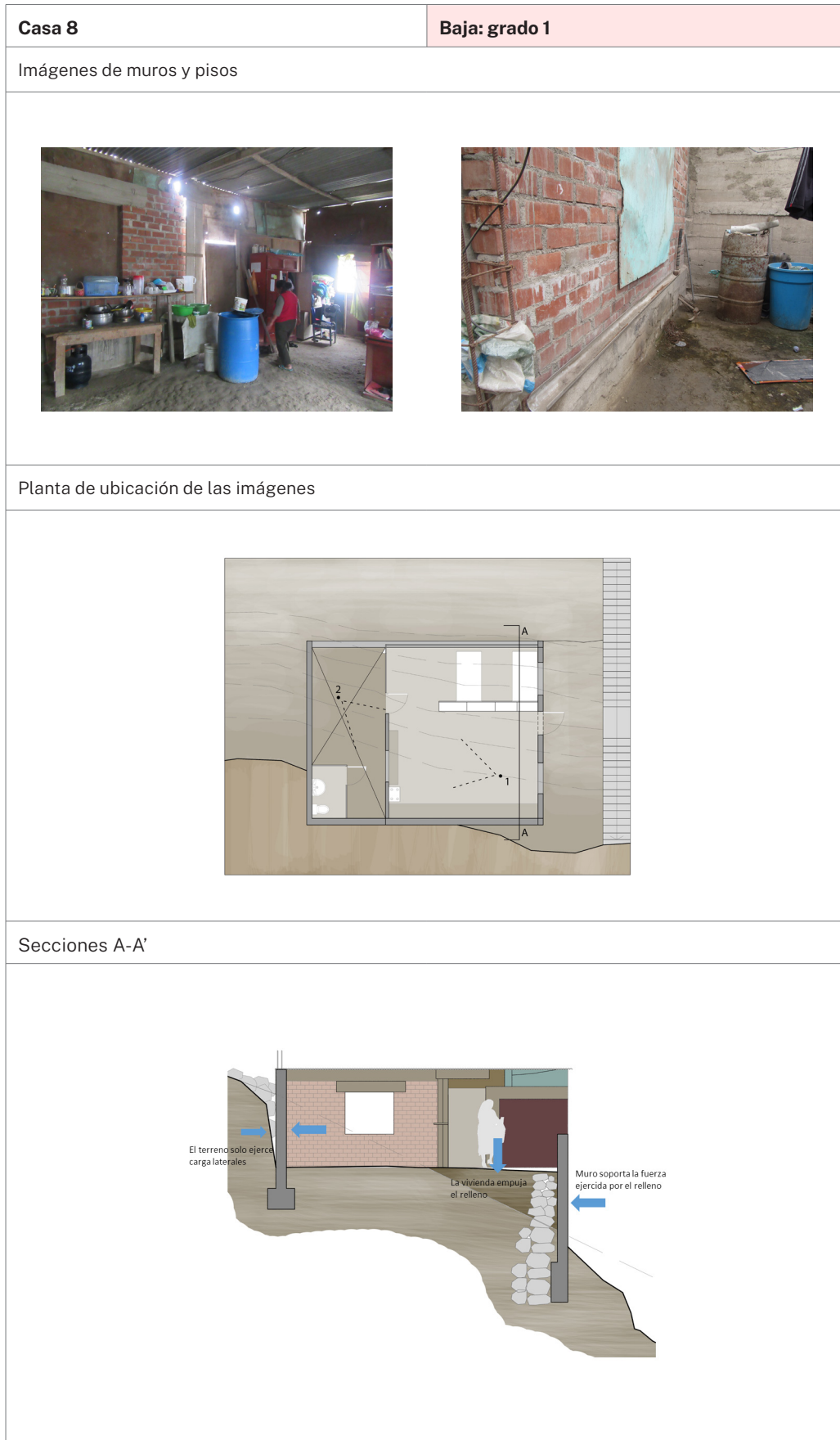
Figura 16. Casa 8: fisuras en muros y pisos presentadas en plantas y cortes. Elaboración propia, 2017.
