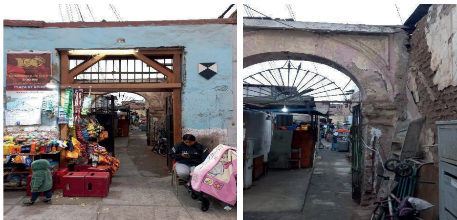
Figura 7. Solar que sufrió daños estructurales por un incendio el año 2015 en la cuadra 8 del jirón Ica con categoría de monumento histórico 4
