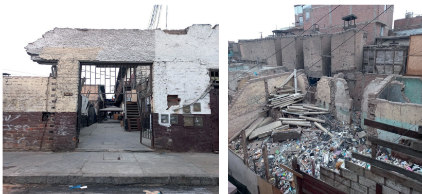
Figura 5. Quinta San Martín en la cuadra 5 del jirón Tayacaja con categoría de monumento histórico 3 con derrumbes internos debido al sismo del 2007
