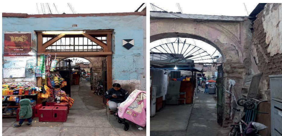
Figura 7. Solar que sufrió daños estructurales por un incendio el año 2015 en la cuadra 8 del jirón Ica con categoría de monumento histórico 4
