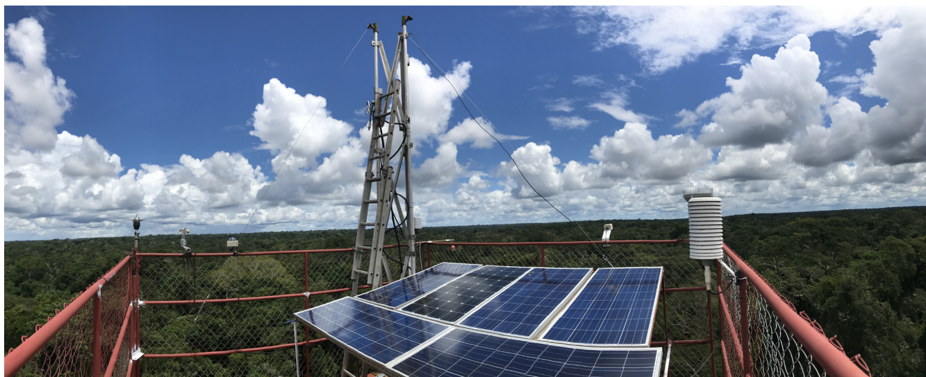
Placas solares en la Torre de Flujos de Carbono de la PUCP, Reserva Nacional Tambopata, Madre de Dios, Perú. Foto de Fabian Limonchi
