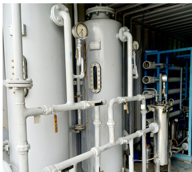
Figura 8. Imagen de una planta de tratamiento de aguas (Fotografía de las autoras).
